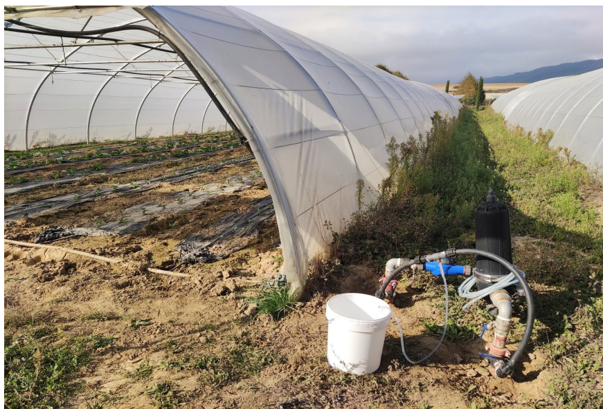
Figura 18. Sistema Venturi para fertirrigación con lixiviados de vermicompost instalado en Josenea.
