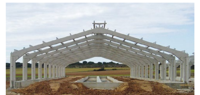
La formación de los futuros ingenieros incluye el diseño y construcción de edificaciones e infraestructuras rurales, como esta nave ganadera.
